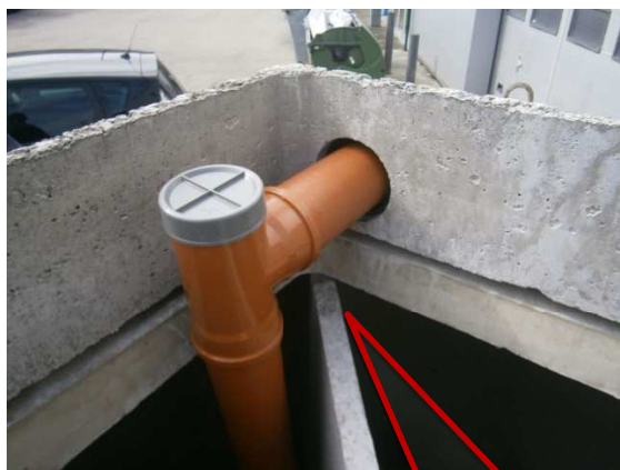
Connexions internes équipées d'origine
